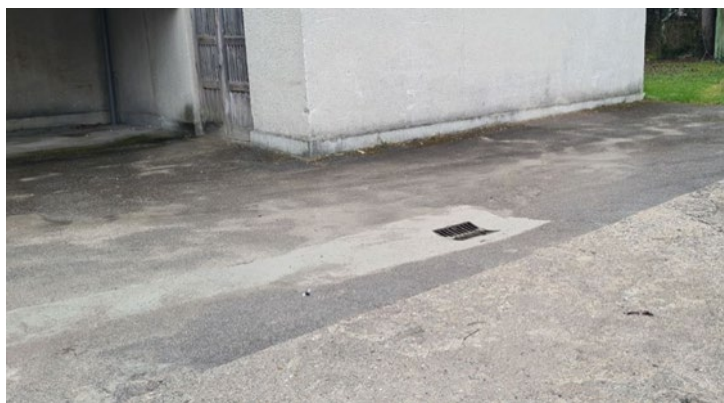
Slika 2.5: Vtok v meteorno kanalizacijo po rekonstrukciji v času padavin
