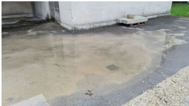
Slika 2.4: Vtok v meteorno kanalizacijo pred rekonstrukcijo v času padavin
